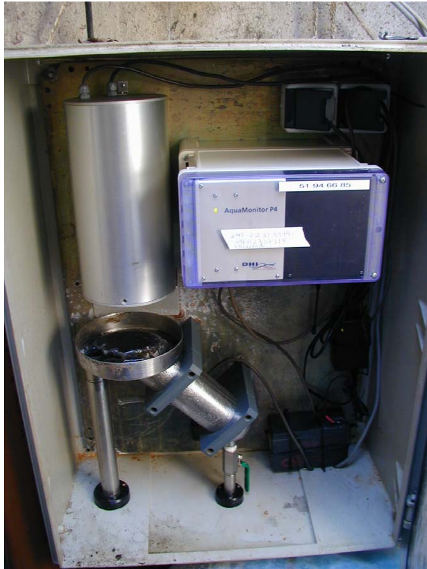
Figur 1 Måleudstyr til online-måling af olie i spildevand.
