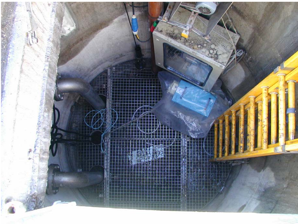
Figur 4.1 Måleopstilling i pumpestation P12.
